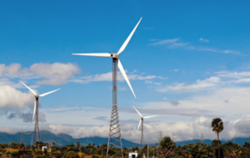
Windfarm bei Tirunelveli im südindischen Bundesstaat Tamil Nadu.
