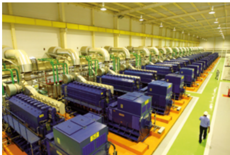
Generatorenhalle eines mit Erdöl betriebenen Wärmekraftwerks in der Küstenstadt Camaçari im Bundesstaat Bahia.
