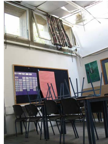
Zerstörung auch im Nachbarraum
