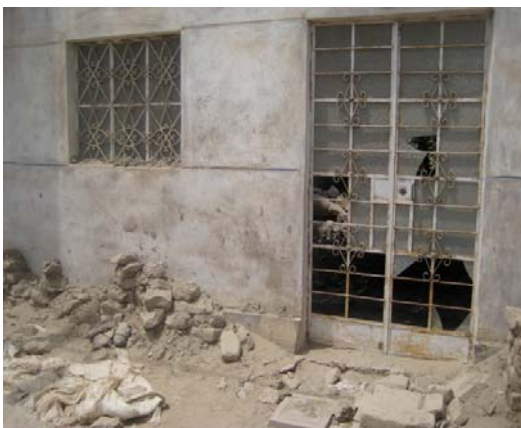
Durch das Erdbeben verursachte Schäden in Ica: zweieinhalb Jahre nach der Katastrophe
