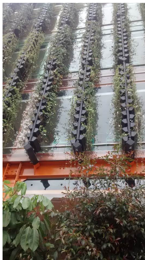
Techos verdes y jardines verticales en Bogotá - ECCI | Crédito: Secretaría Distrital de Ambiente
