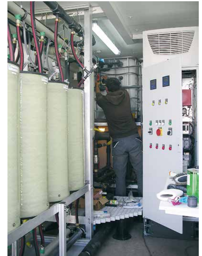
557 Planta de desalinización descentralizada que utiliza energía solar para convertir el agua de mar o agua salobre en agua potable. © Fraunhofer Institut
