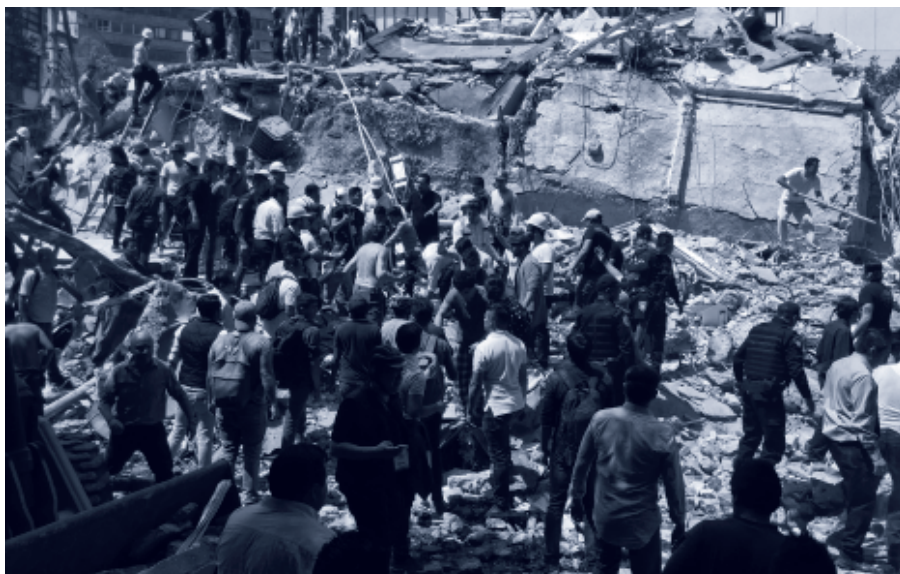
Ciudadanos moviendo escombros en edificio colapsado, Ciudad de México, 19.9.2017. Foto: ProtoplasmaKid, via Wikicommons
