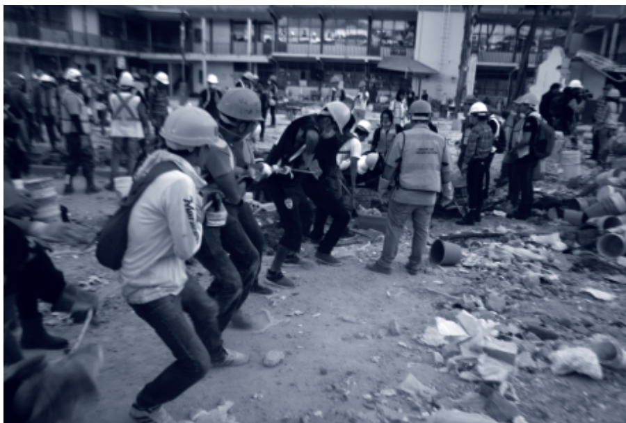
Labores voluntarias en edificio colapsado en Ciudad de México Foto: ProtoplasmaKid, via Wikimedia
