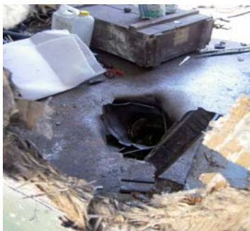
Einschlagstelle der Katjuscha im Nebengebäude
