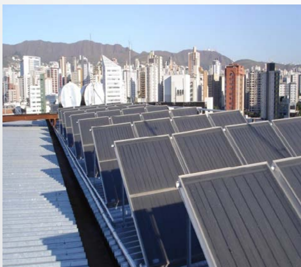
ENERGIA SOLAR TÉRMICA
