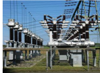
Subestación de transformación
