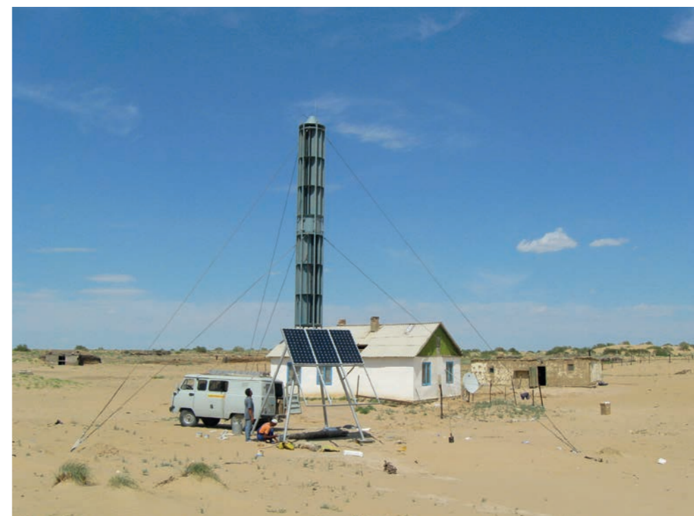
1996 жыл. Қызылорда облысы, Қожаазаған кентінің объектісін қоректендіруге арналған күн-жел қондырғысын монтаждау. Тапсырыс беруші - «Қазақтелеком» АҚ.
