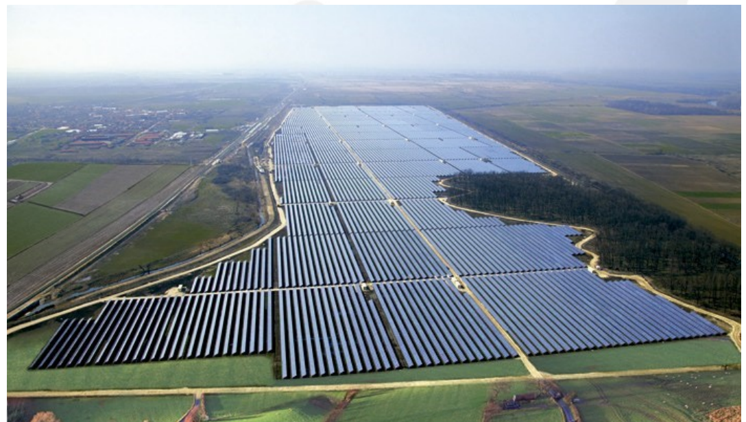
UFV de 225 MWp em Ituverava (BA).
