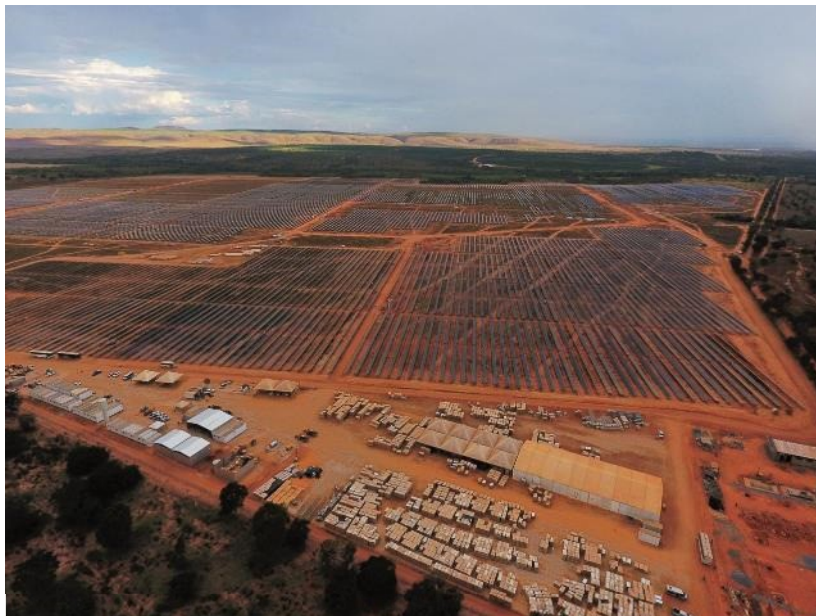
UFV de 185 MWp em Pirapora (MG).
