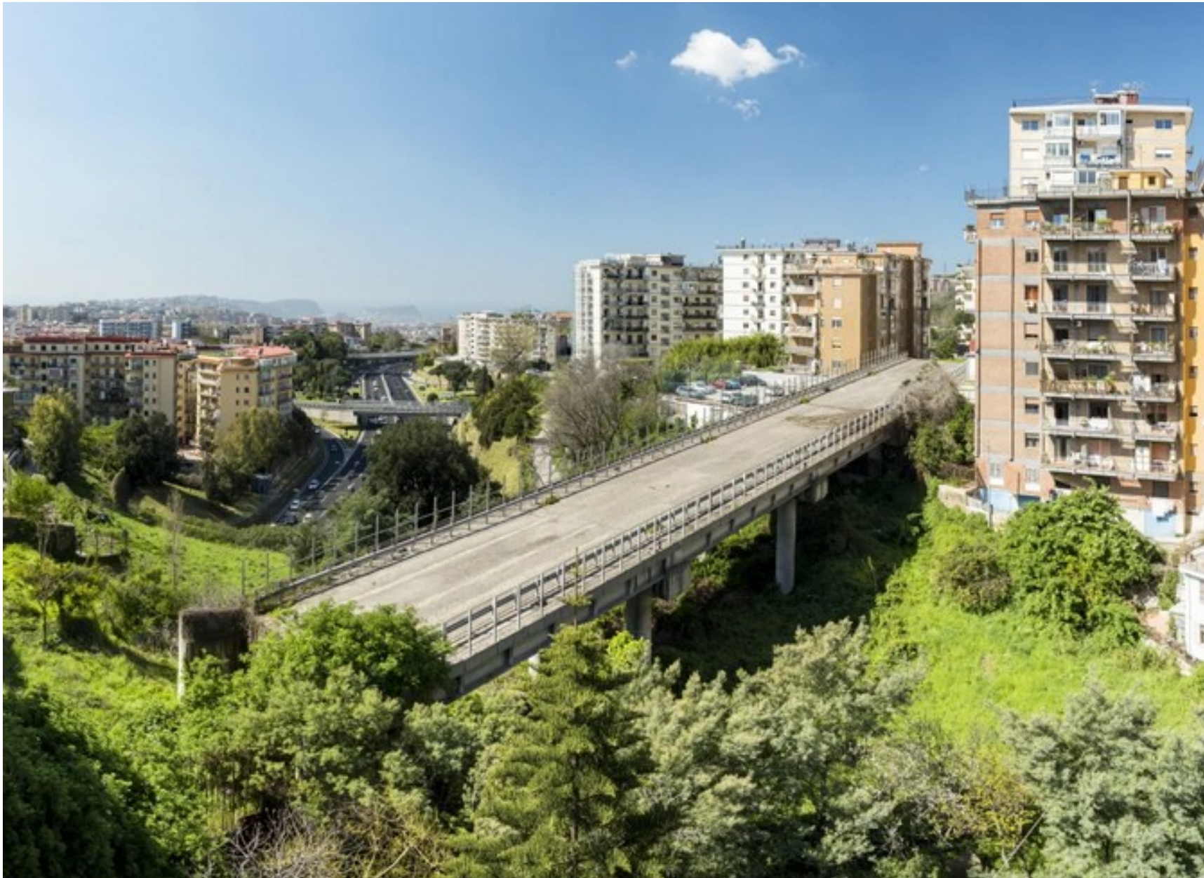
Defekter „Staubsauger“ staatlicher Planung: Bauruine (Straßenbrücke) in Italien
