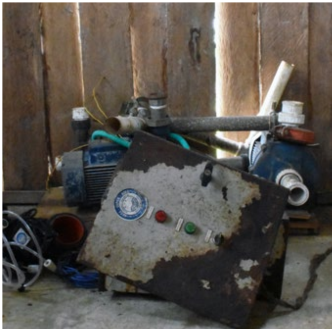
Una obra abandonada y no funcional, como el tanque de agua del corregimiento de Bocas de Telembí, en el municipio de Barba-coas, Nariño, tiene un contrato incumplido detrás. En este caso, la investigación demostró que los trabajos se hicieron sin estudios previos y la obra no tuvo seguimiento, nunca entró en funcionamiento y con ello los motores terminaron abandonados y arruinados. Fotos: Dora Montero / Agosto de 2018.
