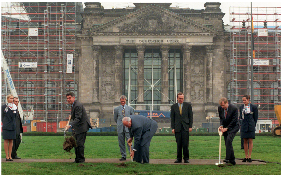
Eberhard Diepgen mit dem Vorstandsvorsitzenden der Deutschen Bahn, Heinz Dürr, und Bundeskanzler Helmut Kohl beim ersten Spatenstich für den Bau des Tiergartentunnels am 13. Oktober 1995 vor dem Reichstagsgebäude.
